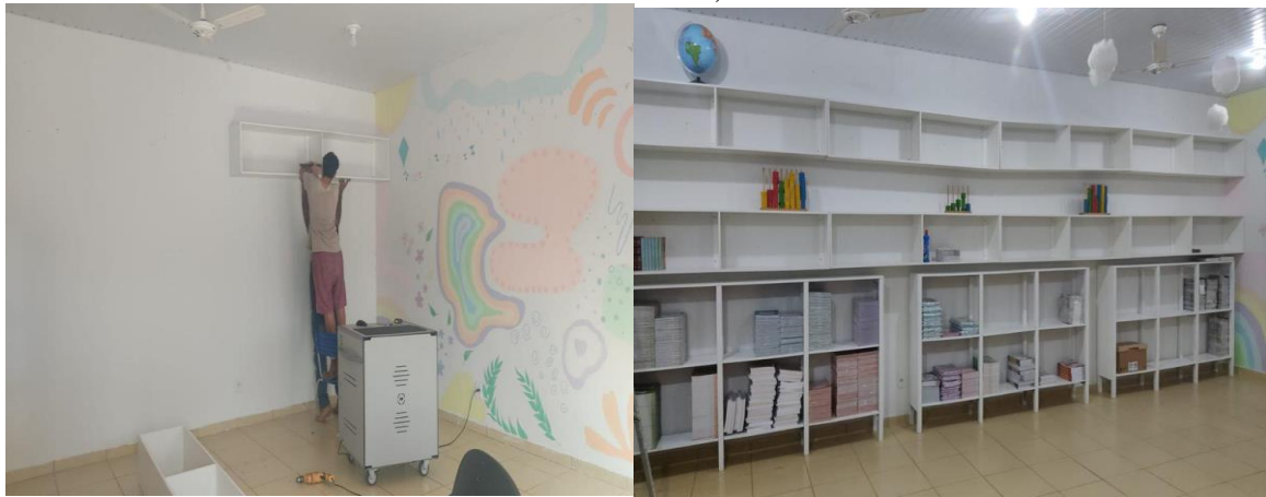
Figura 7 – Dia 7: Instalação dos armários novos e pintura de branco (o armário ficou torto, mas depois foi arrumado)
